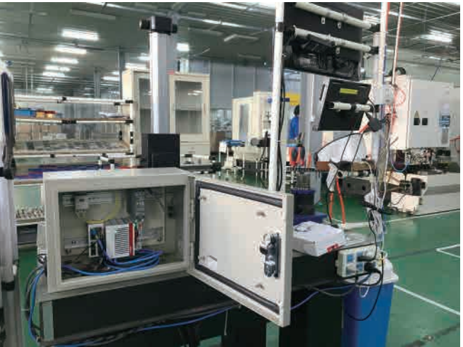
NC 機以外の制御設備にも EPC を設置しデータ連携を実施している
