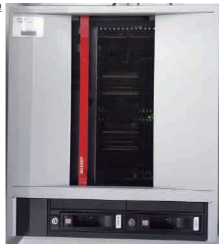
各拠点の工程・データ管理を行う IPC (C6670)
