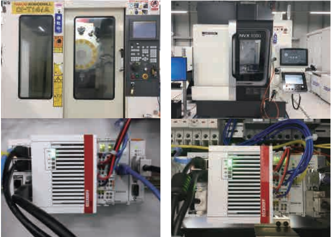
上海工場の工作機械に設置されたEPC<写真左>、本社工場の工作機械に設置されたEPC<写真右>。設備仕様や新旧を問わず、いずれの設備にも CX5140 を搭載
